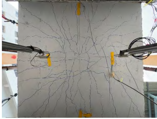
รูปที่ 4-108 ความเสียหายที่เกิดขึ้นบริเวณด้านล่างพื้นสะพานจำลองที่ก่อสร้างด้วยคอนกรีตผสมยางรถยนต์เก่าบดละเอียด แผ่นที่ 2 (ST-CRC15-2)
